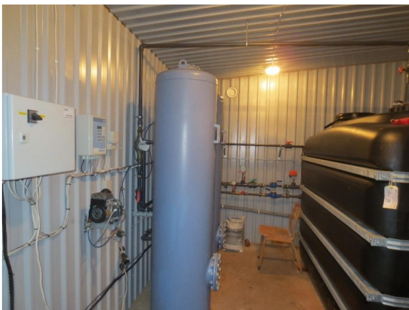
Joonis 5-16 Sonda Rahvamaja pumpla sisevaade (veetötlusfiltrid, veereservuaar)
