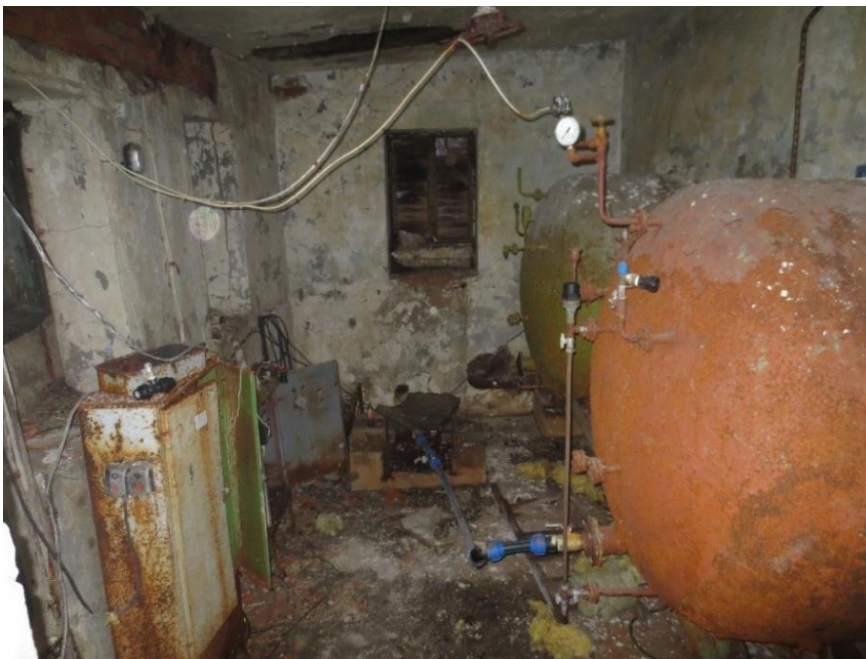
Joonis 5-14 Lüganuse pk-pumpla nr 2 sisevaade
