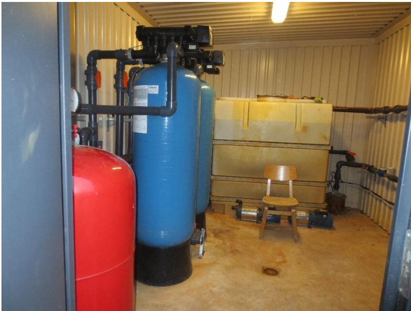
Joonis 5-23 Erra elamute puurkaevpumpla sisevaade
