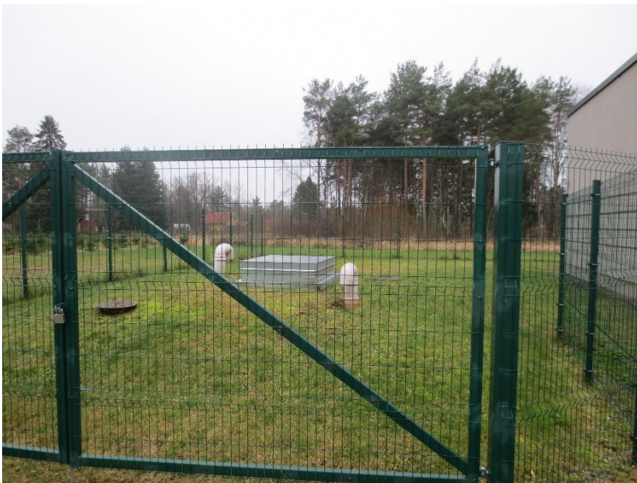
Joonis 5-10 Püssi uue veehaarde (pk nr 2) puurkaev paikneb hoone kõrval šahtis
