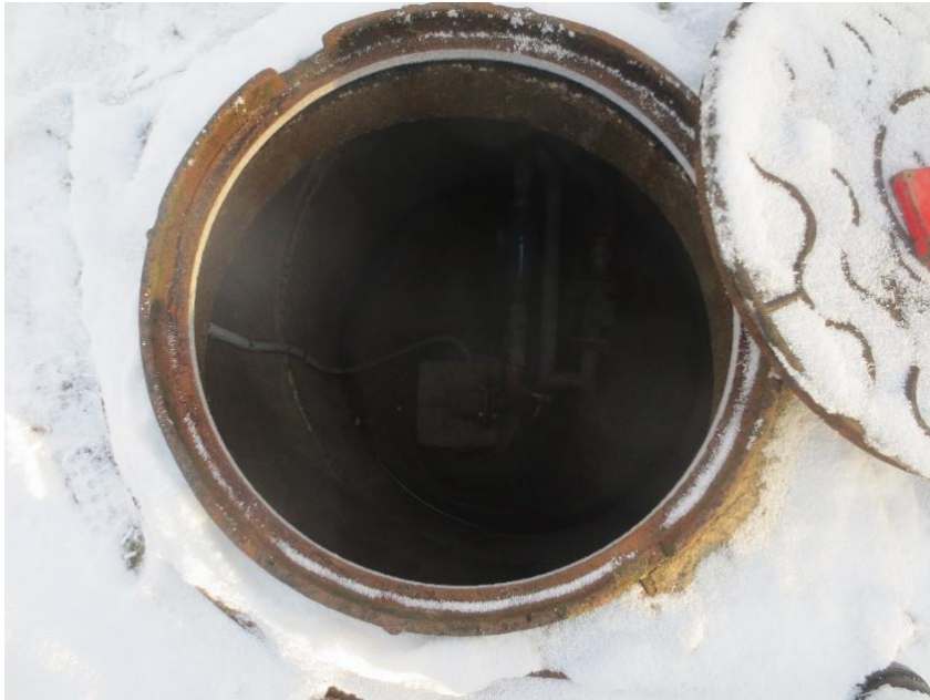
Joonis 5-30 Maidla kooli pk päis asub harilikus betoonšahtis
