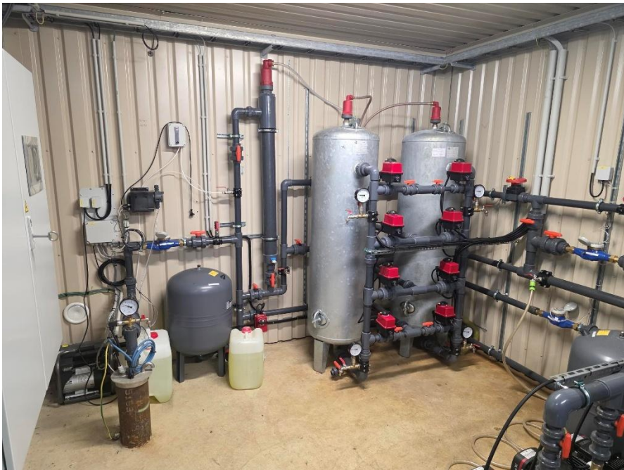
Joonis 5-20 Laane pk-pumpla sisevaade, paarisfilter, vasakul pk päis
