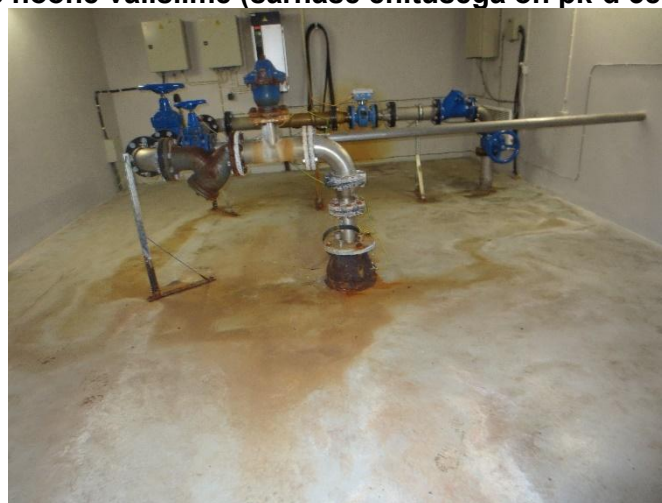
Joonis 5-2 Pk 38 sisevaade (puurkaevu päis, kaugemal veemõõdusõlm ning tagaseinal elektri- ja automaatikaseadmed, sh sagedusmuundur)
