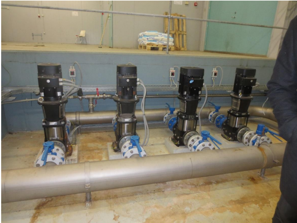
Joonis 5-8 Survetõstepumbad vee pumpamiseks reservuaaridest linnavõrku (Allikad: Konsultandi kogutud andmed ja Lüganuse valla ühisveevärgi- ja kanalisatsiooni arendamise kava aastateks 2021-2032).
