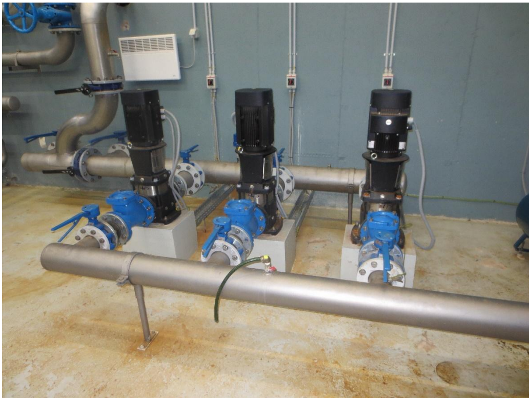
Joonis 5-7 Vahepumbad vee pumpamiseks aeratsioonimahutist survefiltrisse
