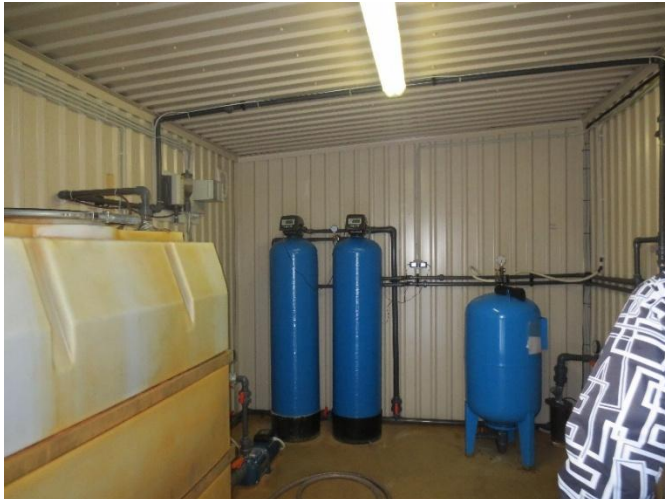
Joonis 5-27 Varja pk sisevaade (aeratsioonimahuti, paarisfilter ja hüdrofoor 200 l)
