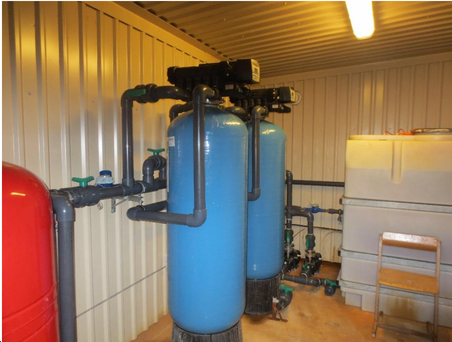
Joonis 5-18 Metsa pumpla sisevaade
