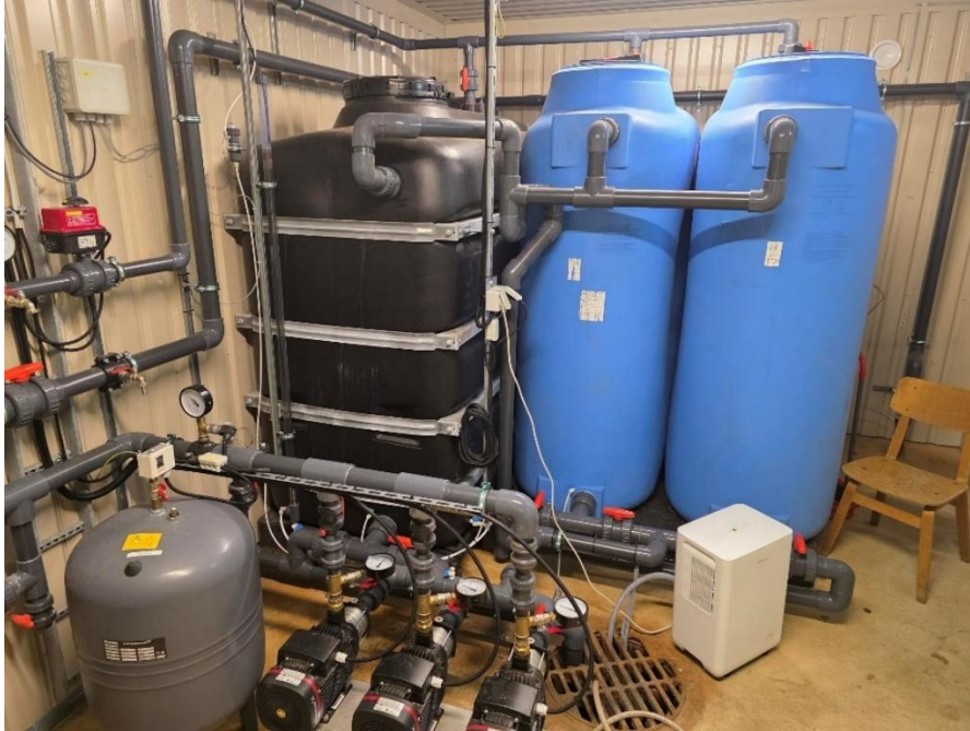
Joonis 5-21 Laane pk-pumpla sisevaade, esiplaanil 2024. a väljavahetatud II-astme võrgupumbad (2 tk) üks pesupump, taga veereservuaarid, sealhulgas kaks sinist mahutit lisatud aastal 2024
