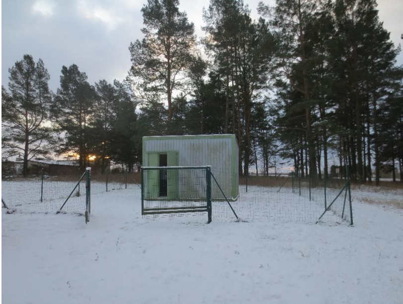
Joonis 5-24 Purtsi keskuse puurkaevpumpla välisilme
