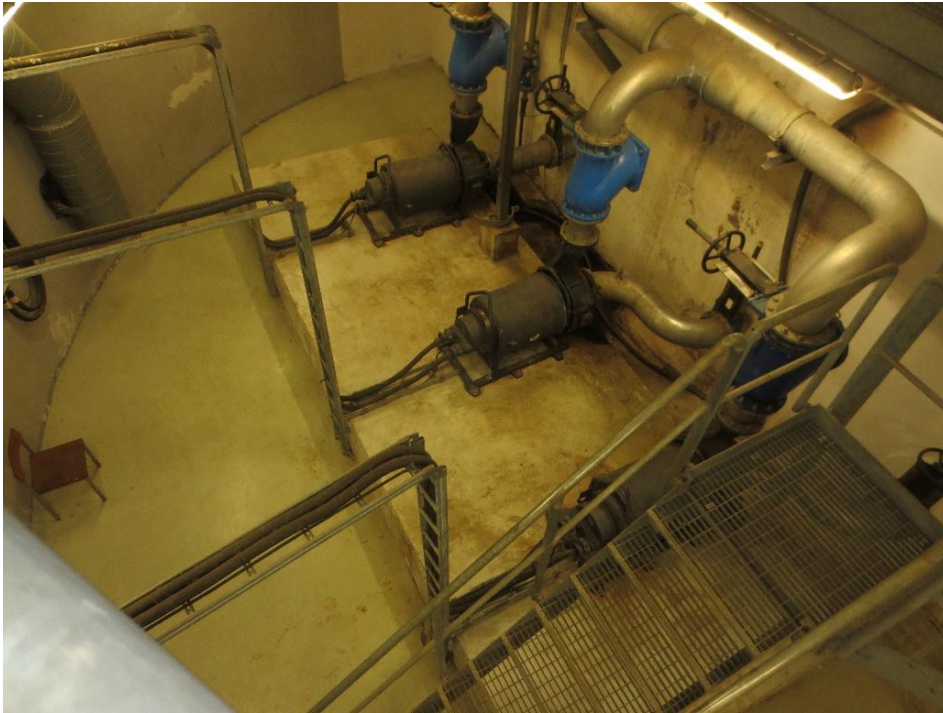
Joonis 6-6 Püssi (regionaalse) peapumpla RP-5 kuivasetusega pumbad (mark: Grundfos)
