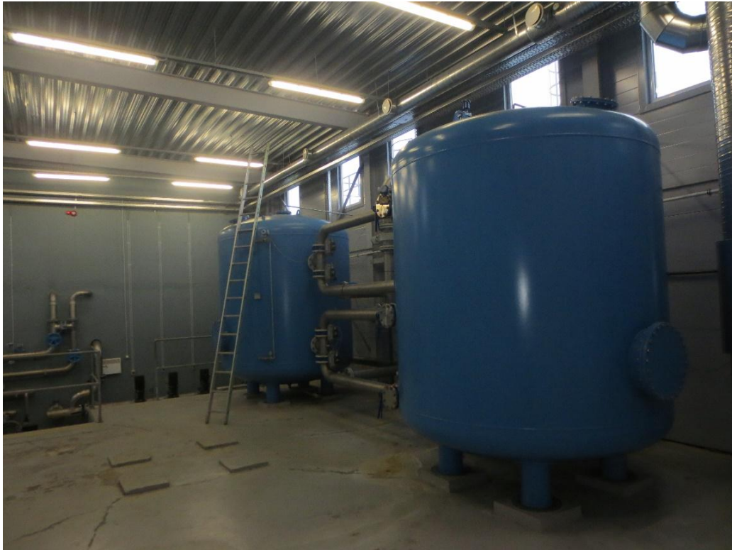
Joonis 5-6 VTJ survefiltrid (kaks filtrit on tänaseks üledimensioneeritud)
