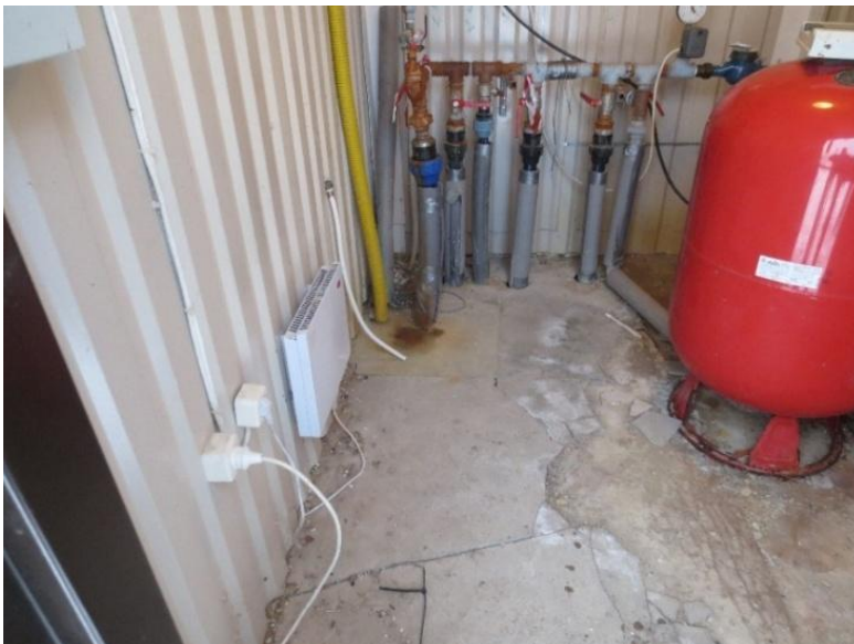
Joonis 5-32 Maidla Kodu pk-pumpla sisevaade (puurkaevu päis, hüdrofoor, näha on arvukad veeühendused)
