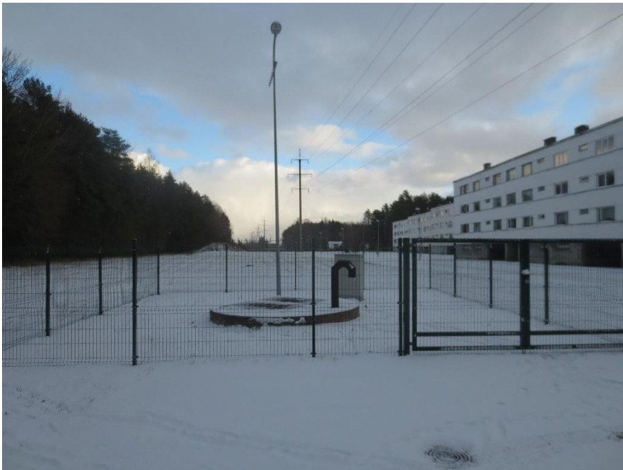
Joonis 6-7 Püssi Viru reoveepumpla RP-3 välisvaade. Tegemist on maa-aluses šahtis paikneva, sukelpumpadega varustatud pumplaga. Pumplat ümbritseb ka piirdeaed
