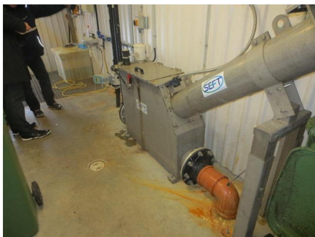
Joonis 6-28 Tehnohoones paiknevad automaatkruvivõre ja koagulandi dosaatorsüsteem
