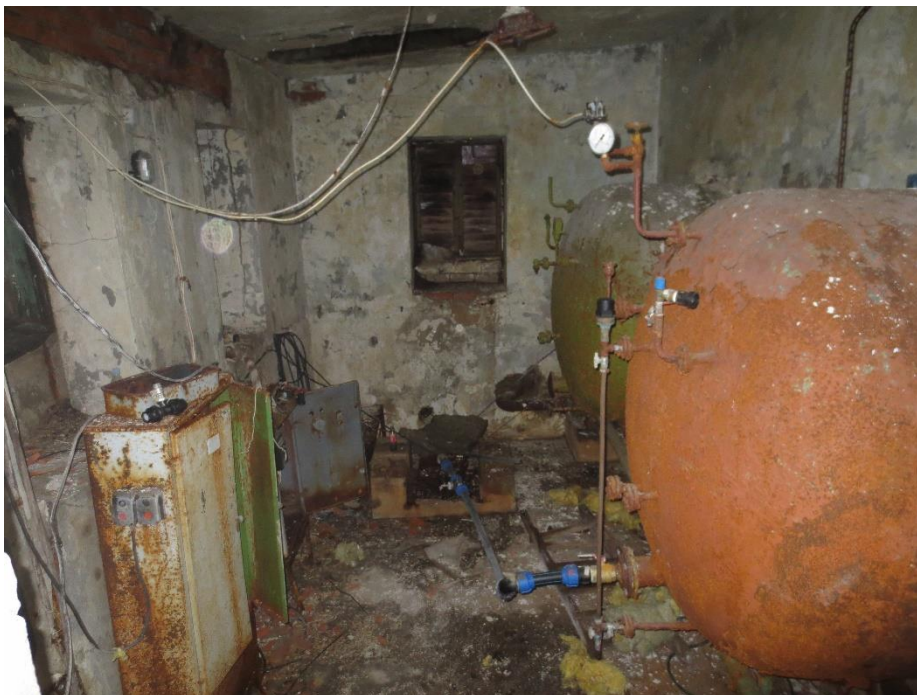
Joonis 5-14 Lüganuse pk-pumpla nr 2 sisevaade
