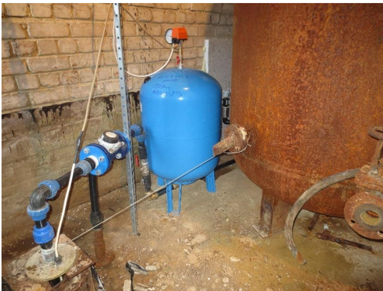
Joonis 5-29 Purtsse sigala pk sisevaade (puurkaevu päis, veearvesti, uus ja vana hüdrofoor)
