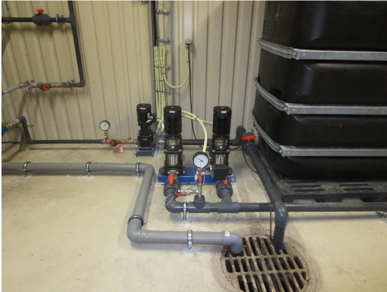
Joonis 5-22 Laane pk-pumpla sisevaade, esiplaanil II-astme võrgupumbad, taga pesupump, paremal fragment veereservuaarist
