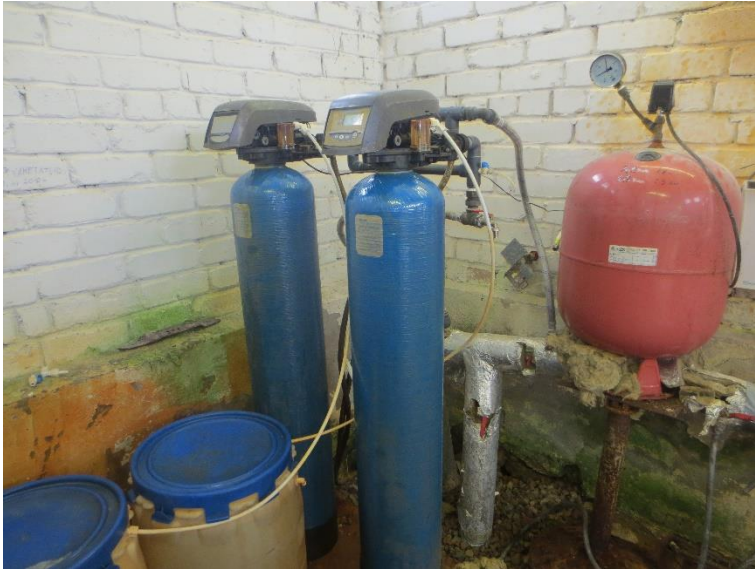
Joonis 5-40 Uniküla pk-pumpla sisevaade (vasakult: kaaliumpermanganaadi mahutid, survefiltrid ja 100 l hüdrofoor)
