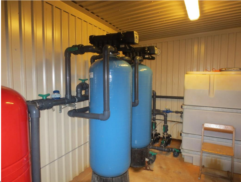
Joonis 5-19 Metsa pumpla sisevaade
