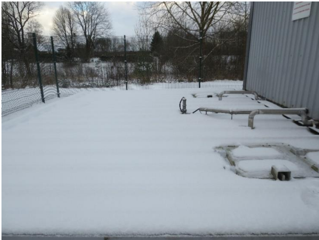
Joonis 6-32 Savala-Uniküla reoveepuhasti aerotank paikneb osaliselt väljaspool tehnohoonet, kuid on kaetud
