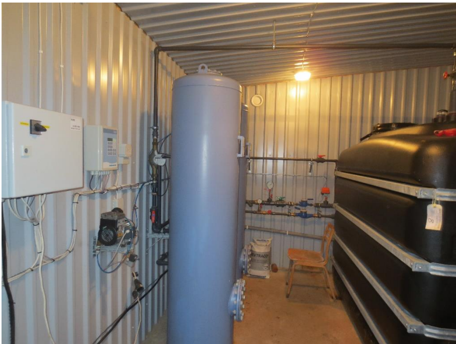
Joonis 5-17 Sonda Rahvamaja pumpla sisevaade (veetötlusfiltrid, veereservuaar)
