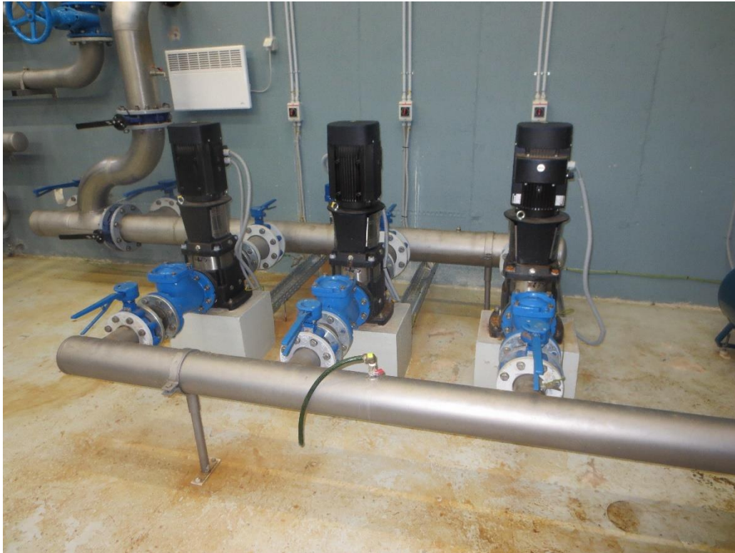
Joonis 5-7 Vahepumbad vee pumpamiseks aeratsioonimahutist survefiltrisse
