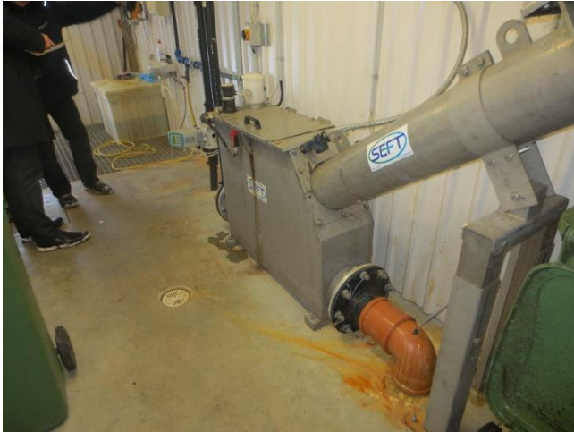
Joonis 6-33 Tehnohoones paiknevad automaatkruvivõre ja koagulandi dosaatorsüsteem
