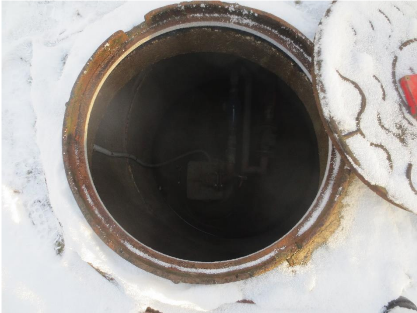
Joonis 5-34 Maidla kooli pk päis asub harilikus betoonšahtis
