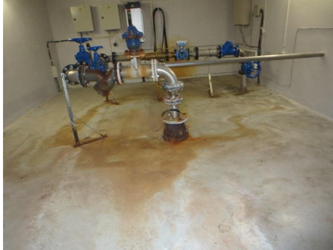
Joonis 5-2 Pk 38 sisevaade (puurkaevu päis, kaugemal veemõõdusõlm ning tagaseinal elektri- ja automaatikaseadmed, sh sagedusmuundur)
