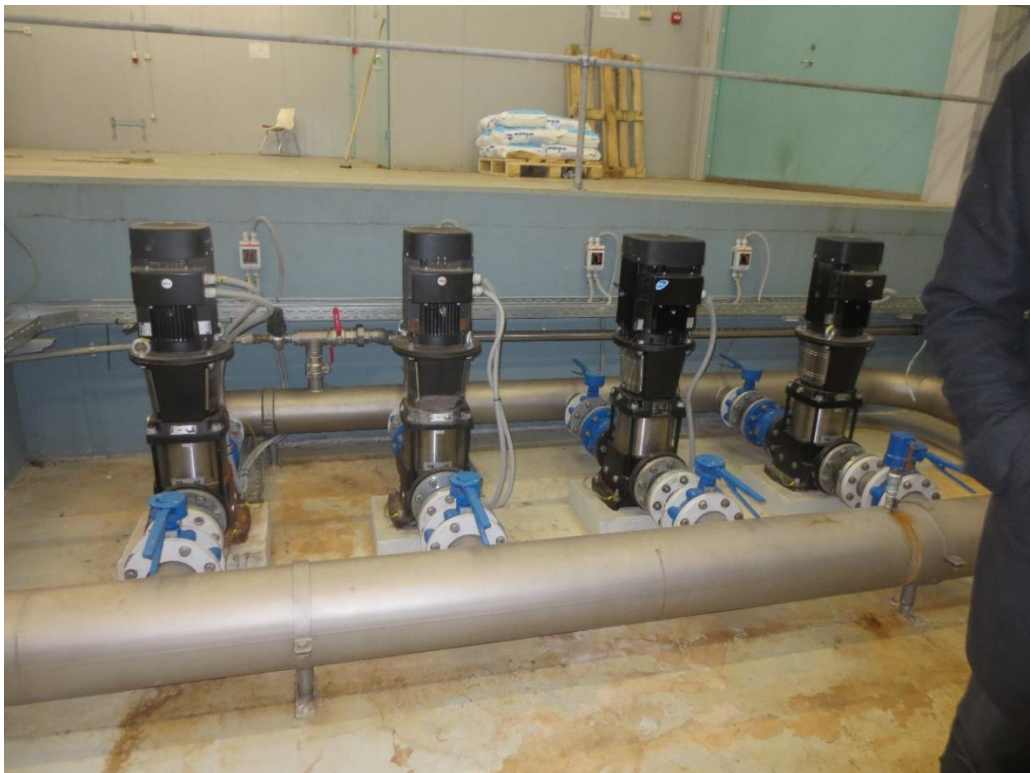
Joonis 5-8 Survetõstepumbad vee pumpamiseks reservuaaridest linnavõrku
