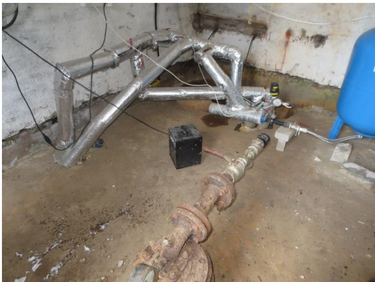
Joonis 5-47 Soonurme pumpla sisevaade, esiplaanil vana ammu seisva puurkaevu päis. (Peale membraanhüdrofoori ja mõne sulgeseadme pumplas palju säilitamisväärsed pole. Soovitav on asendada ka täielikult amortiseerunud hoone
