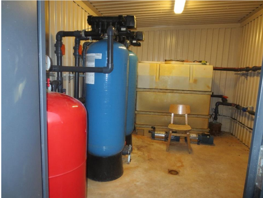
Joonis 5-25 Erra elamute puurkaevpumpla sisevaade
