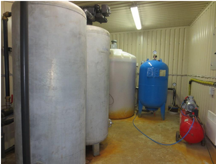
Joonis 5-13 Lüganuse pk-pumpla nr 1 sisevaade (veetöötlusfiltrid, kompressor, hüdrofoor)
