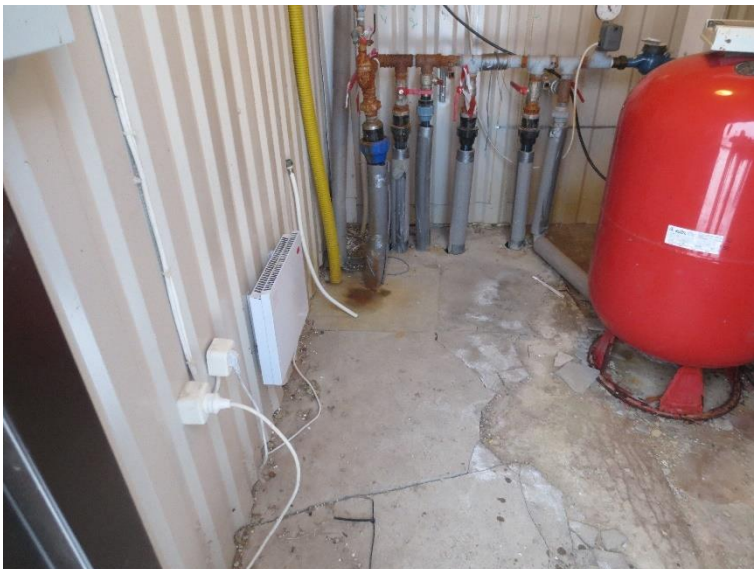
Joonis 5-36 Maidla Kodu pk-pumpla sisevaade (puurkaevu päis, hüdrofoor, näha on arvukad veeühendused puurkaevust)
