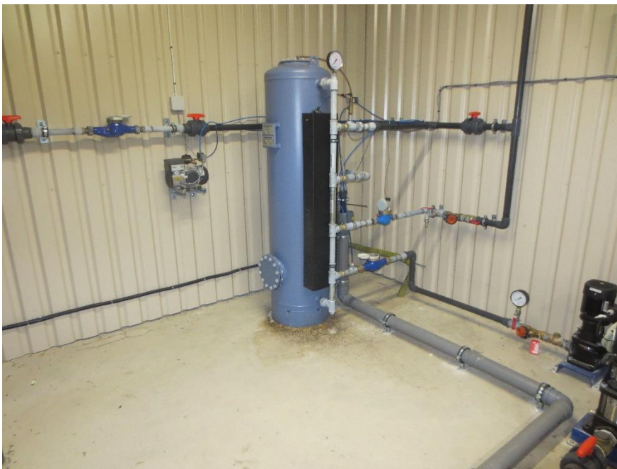
Joonis 5-21 Laane pk-pumpla sisevaade, üksikfilter
