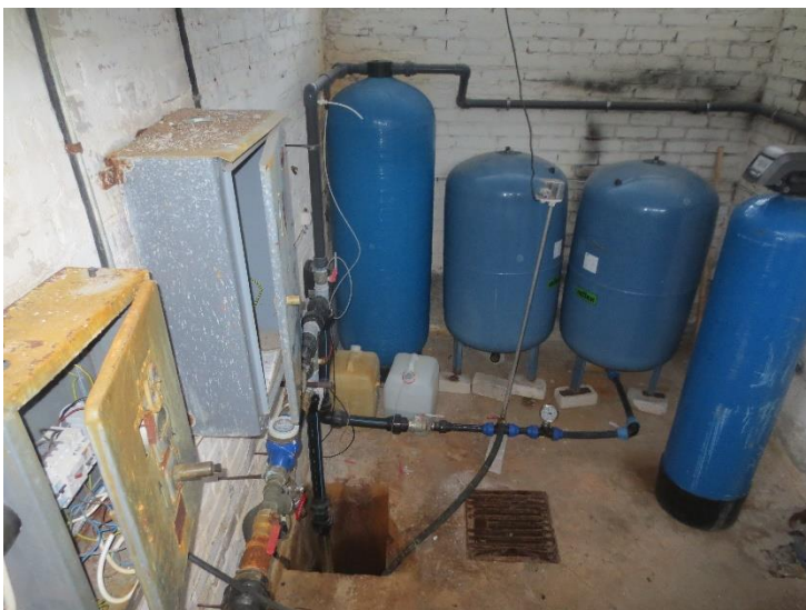
Joonis 5-38 Savala pumpla sisevaade (paremal aeratsioonimahuti, keskel membraanhüdrofoorid ja vasakul survefilter löplikuks rauaeralduseks)
