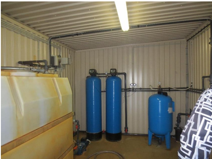
Joonis 5-31 Varja pk sisevaade (aeratsioonimahuti, paarisfilter ja hüdrofoor 200 l)
